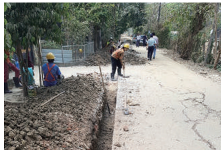
ミャンマーで通信ケーブルを埋めるための工事の様子
